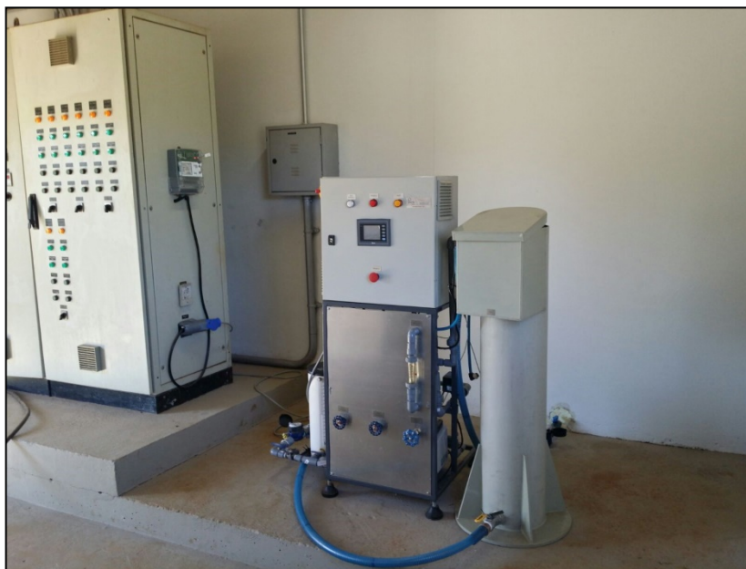
Figura 2 – Planta-piloto FMS PTARH-UnB/CAESB instalada no interior da Casa de Química da ETE Gama. Detalhe do Medidor de energia elétrica instalado na lateral do console do quadro elétrico já existente.
